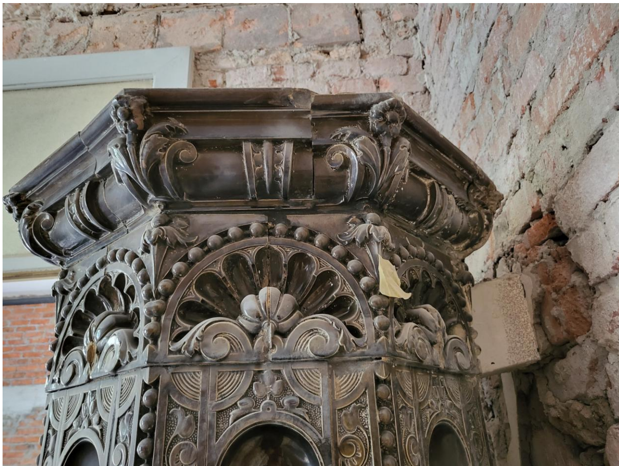
FOTOGRAFIJA 23 Detalj kape KAMINA 4 sa vidljivim oštećenjima rubnih dijelova elemenata i popucalih fuga te nepravilno presloženih elemenata koji ne prate horizontalnost i vertikalnost fuga. Fotografirano u lipnju 2023. godine.
