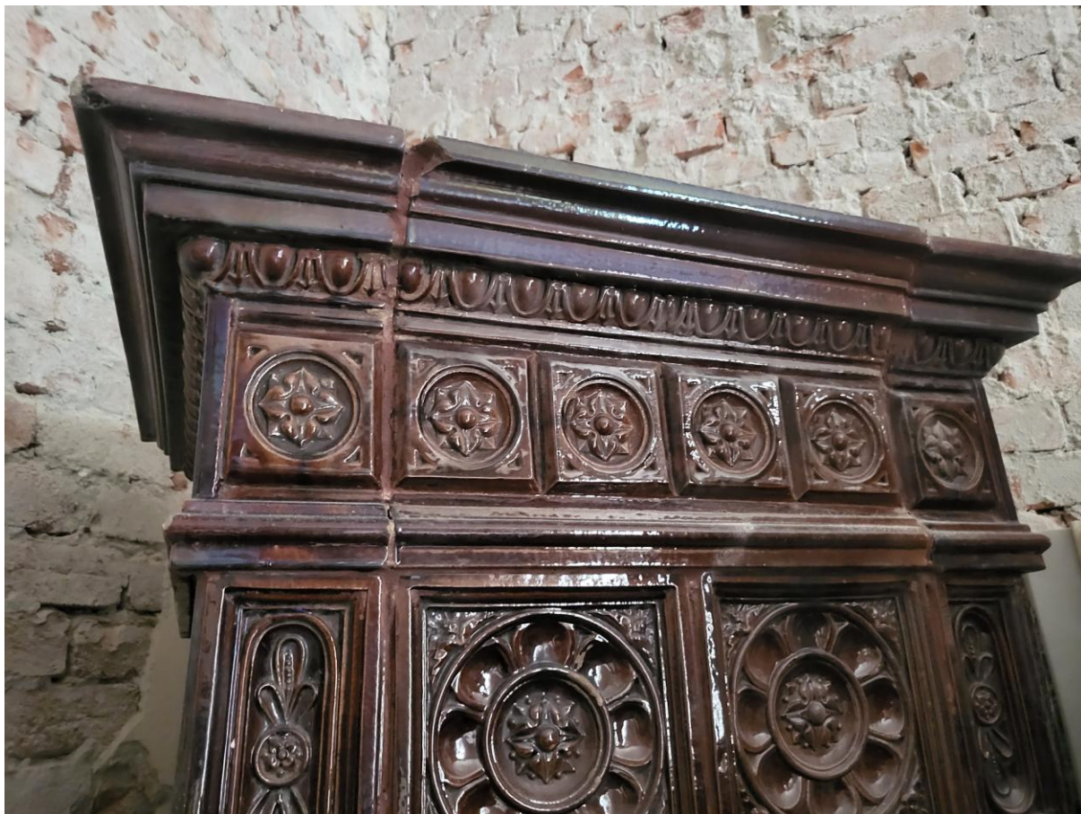
FOTOGRAFIJA 16 Detalj kape KAMINA 3 sa vidljivim oštećenjima rubnih dijelova elemenata i popucalih fuga te nepravilno presloženih elemenata koji ne prate horizontalnost fuga. Fotografirano u lipnju 2023. godine.
