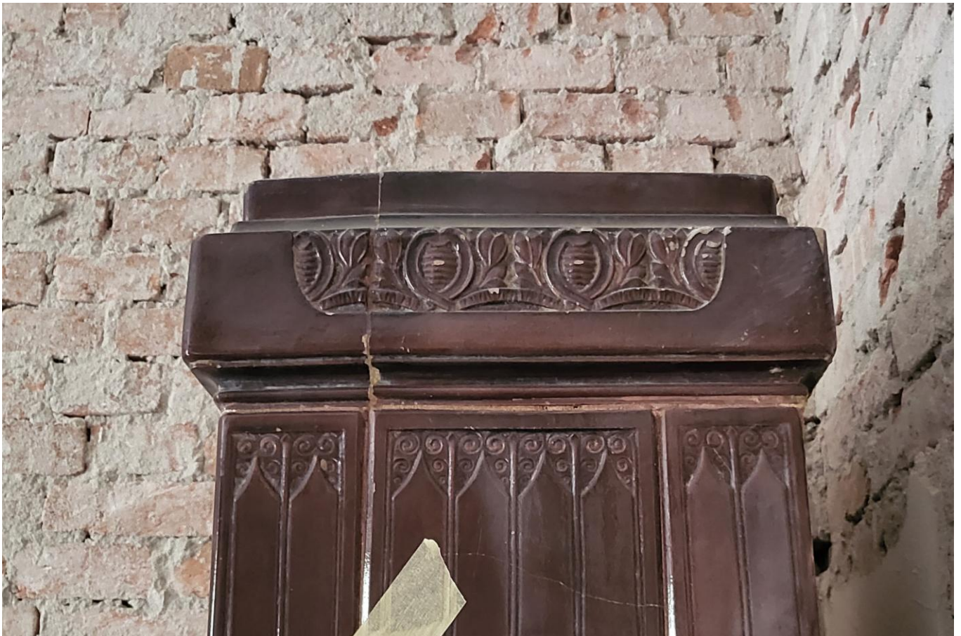
FOTOGRAFIJA 9 Detalj kape KAMINA 2 sa vidljivim oštećenjima slomljenih elemenata i popucalih fuga. Fotografirano u lipnju 2023. godine.
