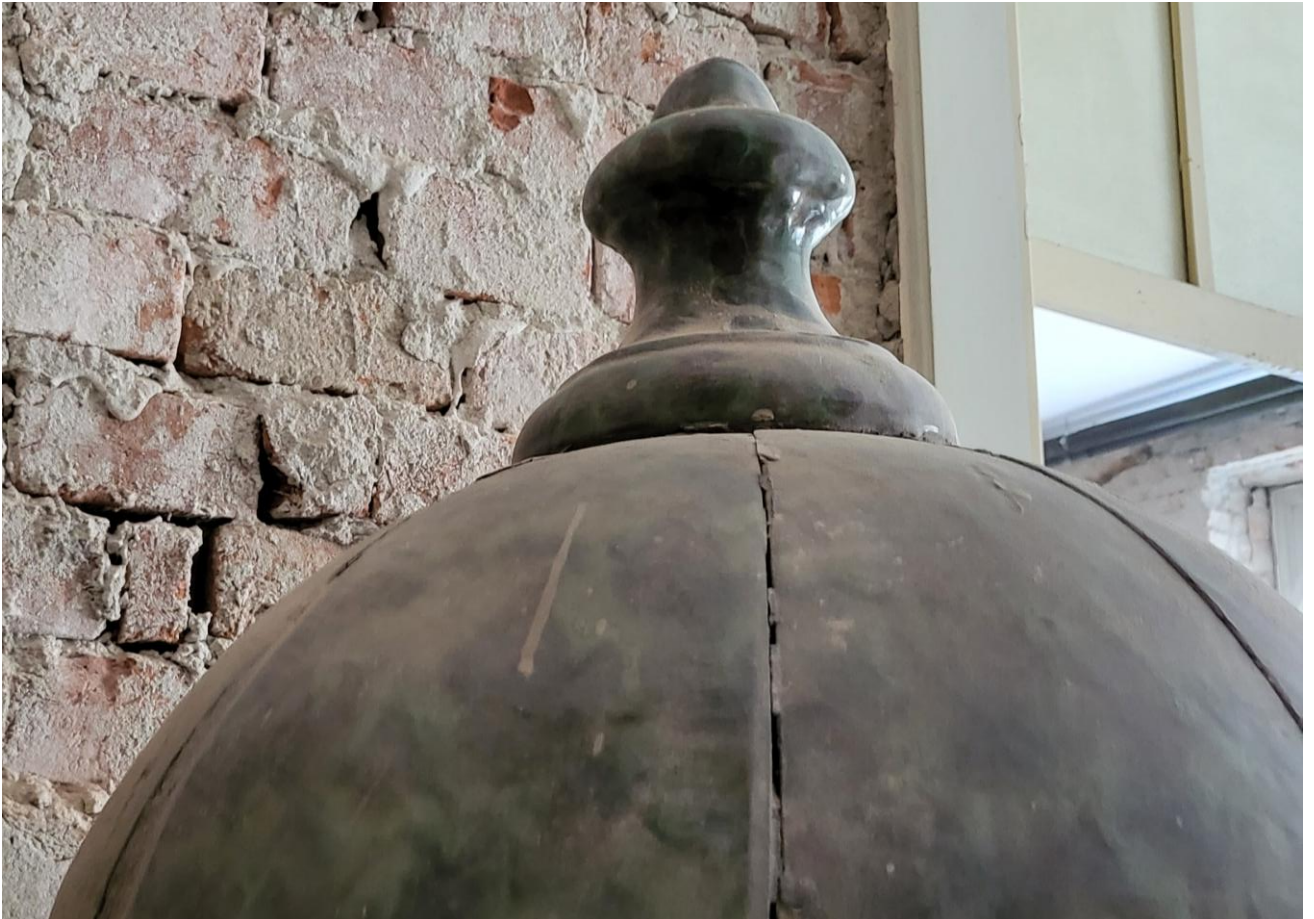
FOTOGRAFIJA 30 Detalj kape KAMINA 5 sa vidljivim oštećenjima rubnih dijelova elemenata i popucalih fuga. Fotografirano u lipnju 2023. godine.
