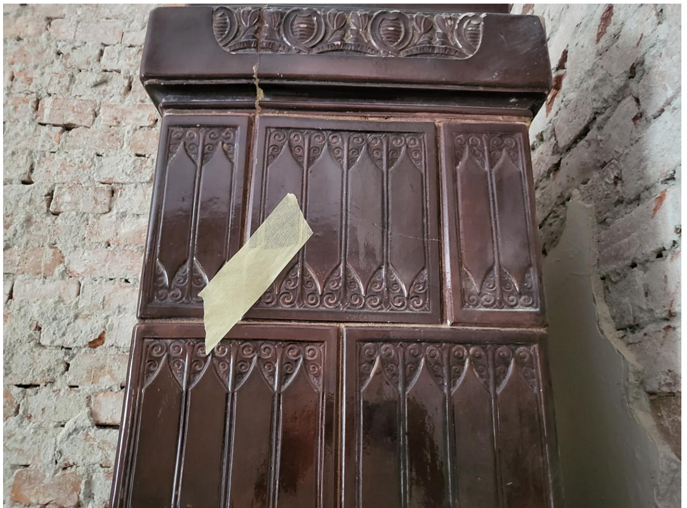
FOTOGRAFIJA 10 Detalj gornjeg dijela KAMINA 2 sa vidljivim oštećenjima i izmaknutim fugama u izvornom? postavljanju ili naknadnom preslagivanju kamina. Fotografirano u lipnju 2023. godine.
