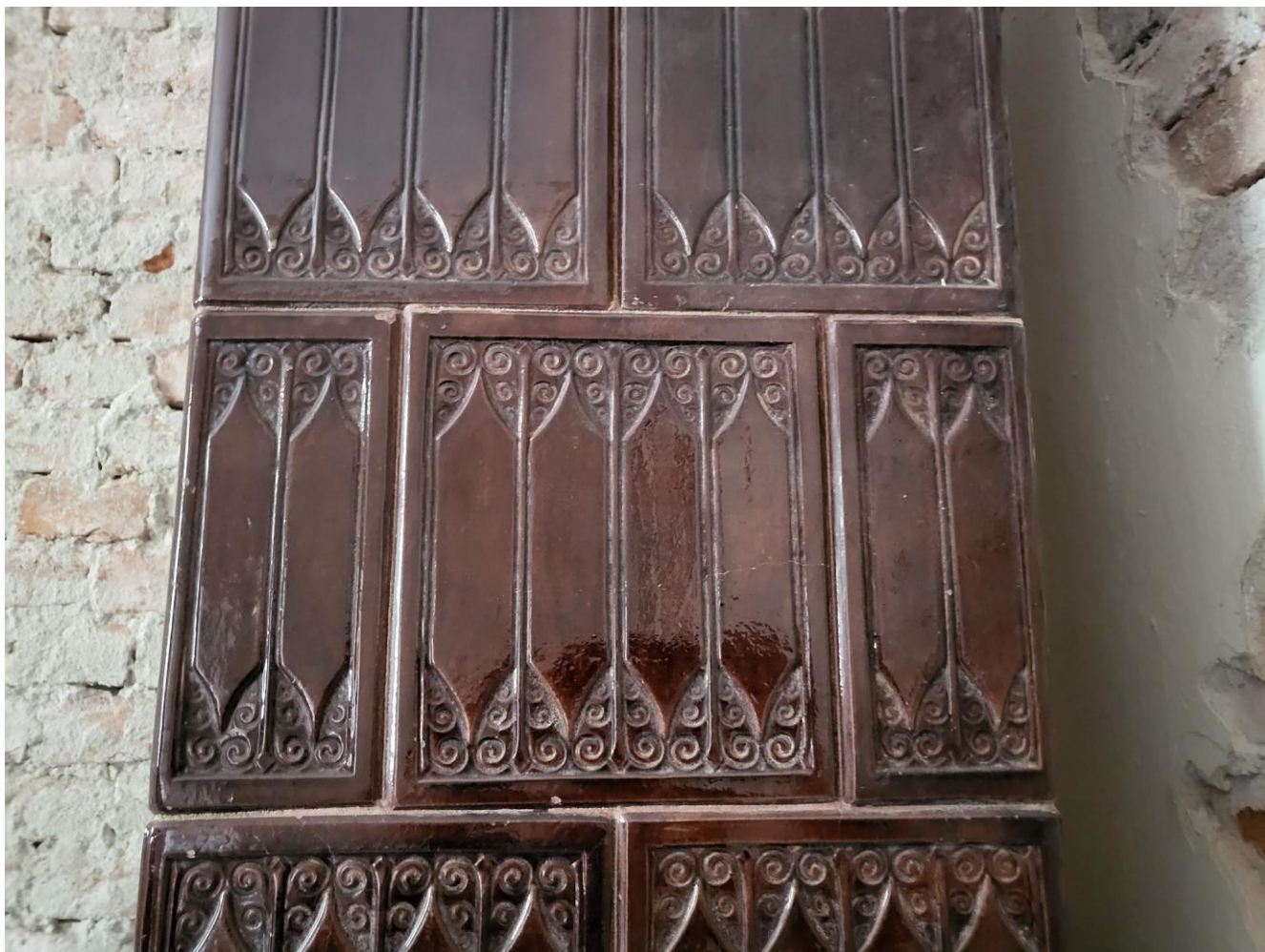
FOTOGRAFIJA 11 Detalj srednjeg dijela KAMINA 2 sa vidljivim slomljenim i popucalim elementima vjerojatno uslijed potresa. Fotografirano u lipnju 2023. godine.
