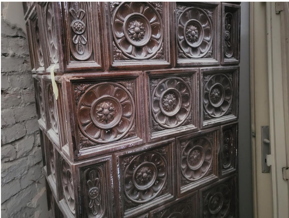
FOTOGRAFIJA 19 Detalj srednjeg dijela KAMINA 3 sa vidljivim oštećenjima površinskog sloja elemenata. Fotografirano u lipnju 2023. godine.
