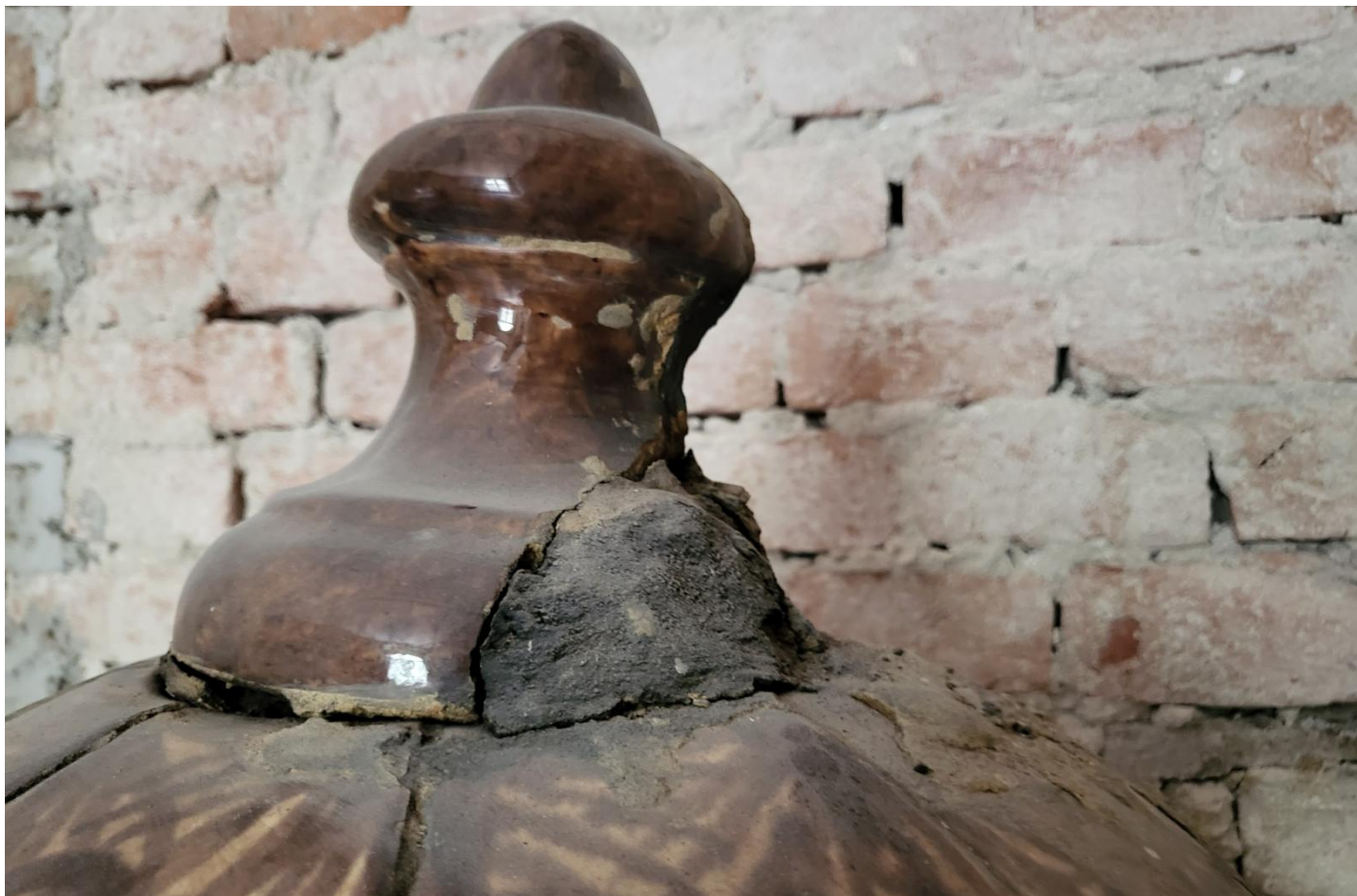
FOTOGRAFIJA 2 Detalj kape KAMINA 1 sa vidljivim oštećenjima i recentnim zakrpama. Fotografirano u lipnju 2023. godine.
