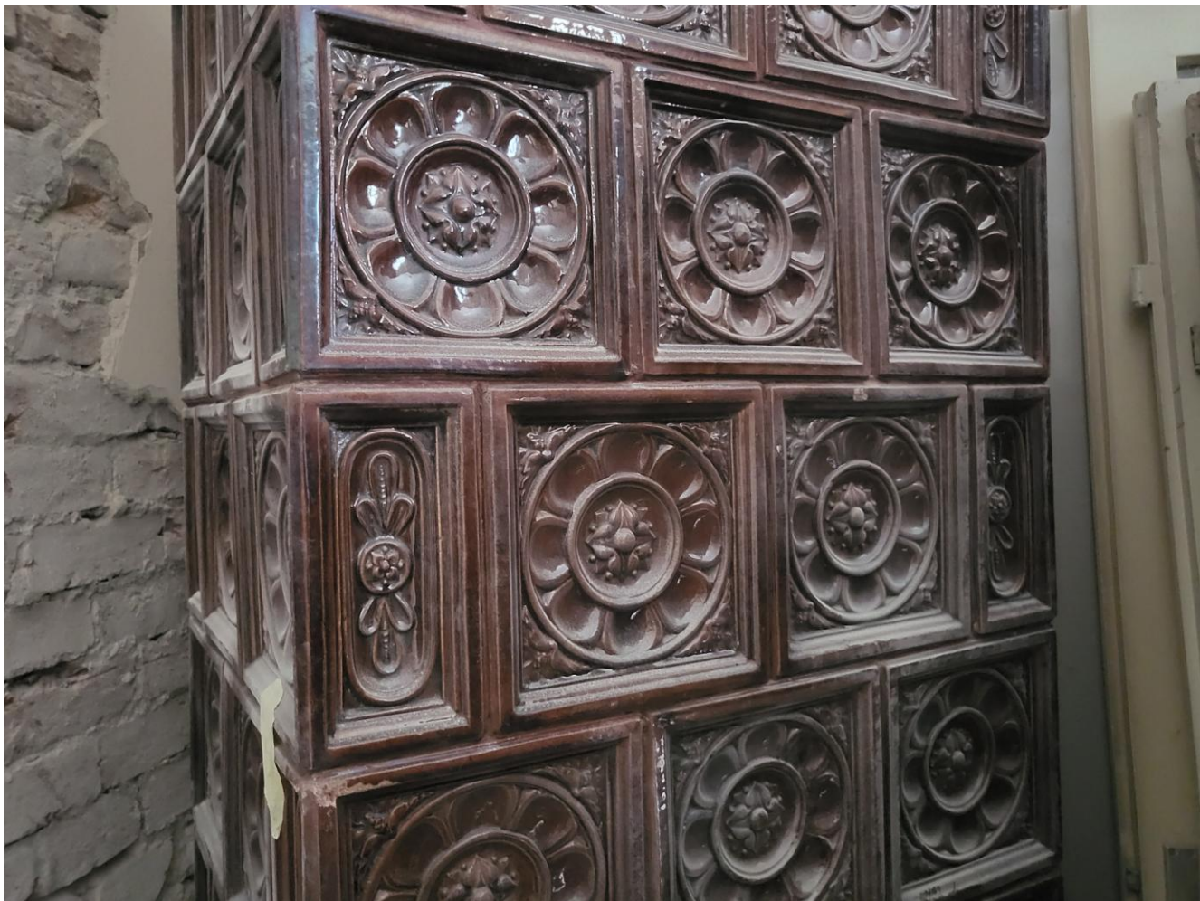
FOTOGRAFIJA 18 Detalj srednjeg dijela KAMINA 3 sa vidljivim oštećenjima površinskog sloja elemenata. Fotografirano u lipnju 2023. godine.
